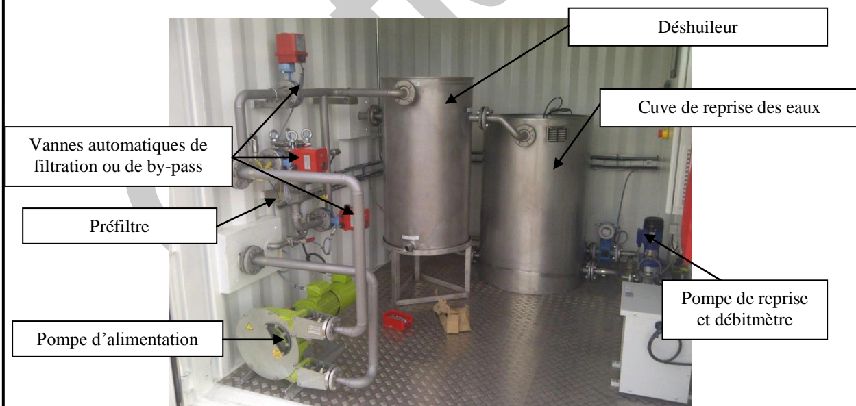
Figure 1: Vue de l'intérieur de l'unité de déshuilage
